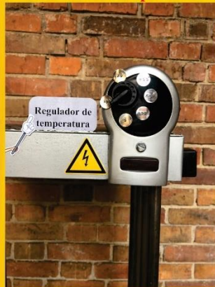
Control de temperatura
